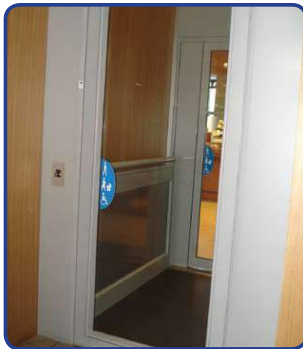
Figura 100 – Plataforma elevatória de percurso vertical
