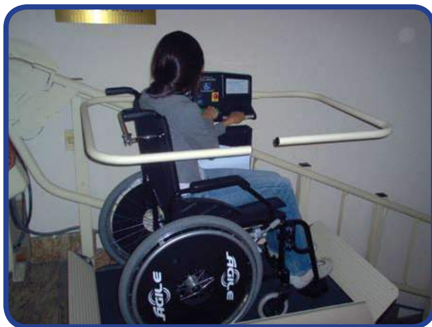
Figura 103 – Plataforma elevatória de percurso inclinado
